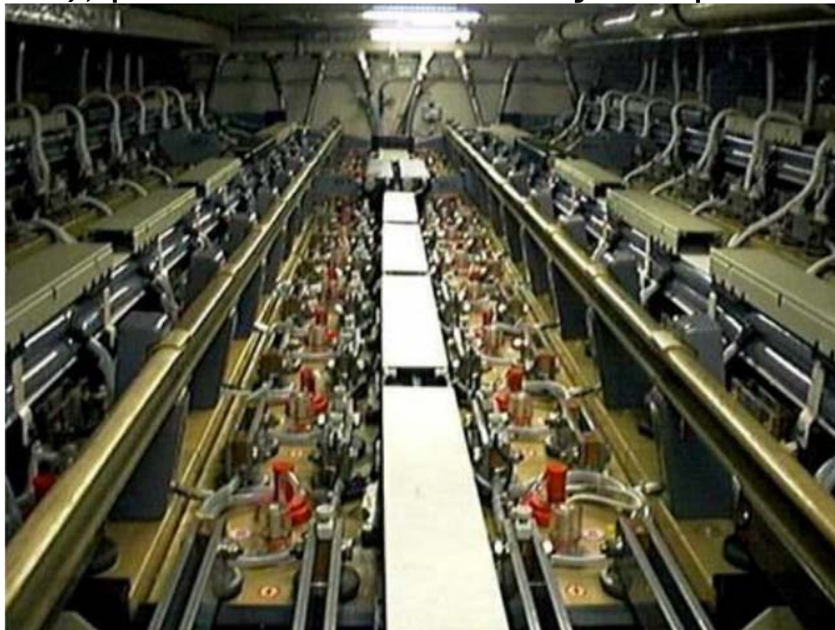
Banco de baterías de un submarino. Potencia pico 500kW
